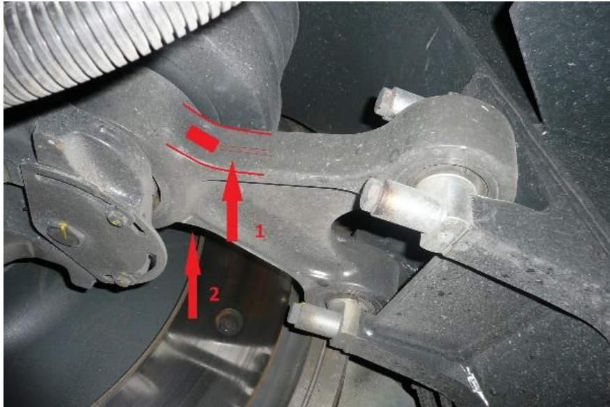
Rys. 7.20 Widok prowadnika z miejscem przewidzianym na umieszczenie tensometrów [5]
