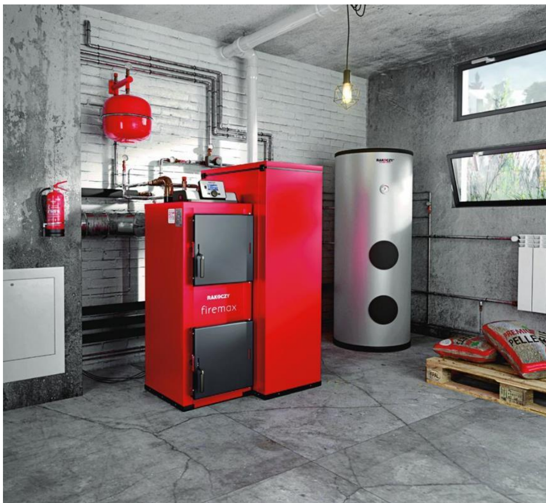
Ilustracja 66. Pomieszczenie techniczne z kotłem na biomasę [źródło: https://miesiecznik.murator.pl/instalacje/kociol-na-pelety_5755.html , dostęp 17.12.2021].
