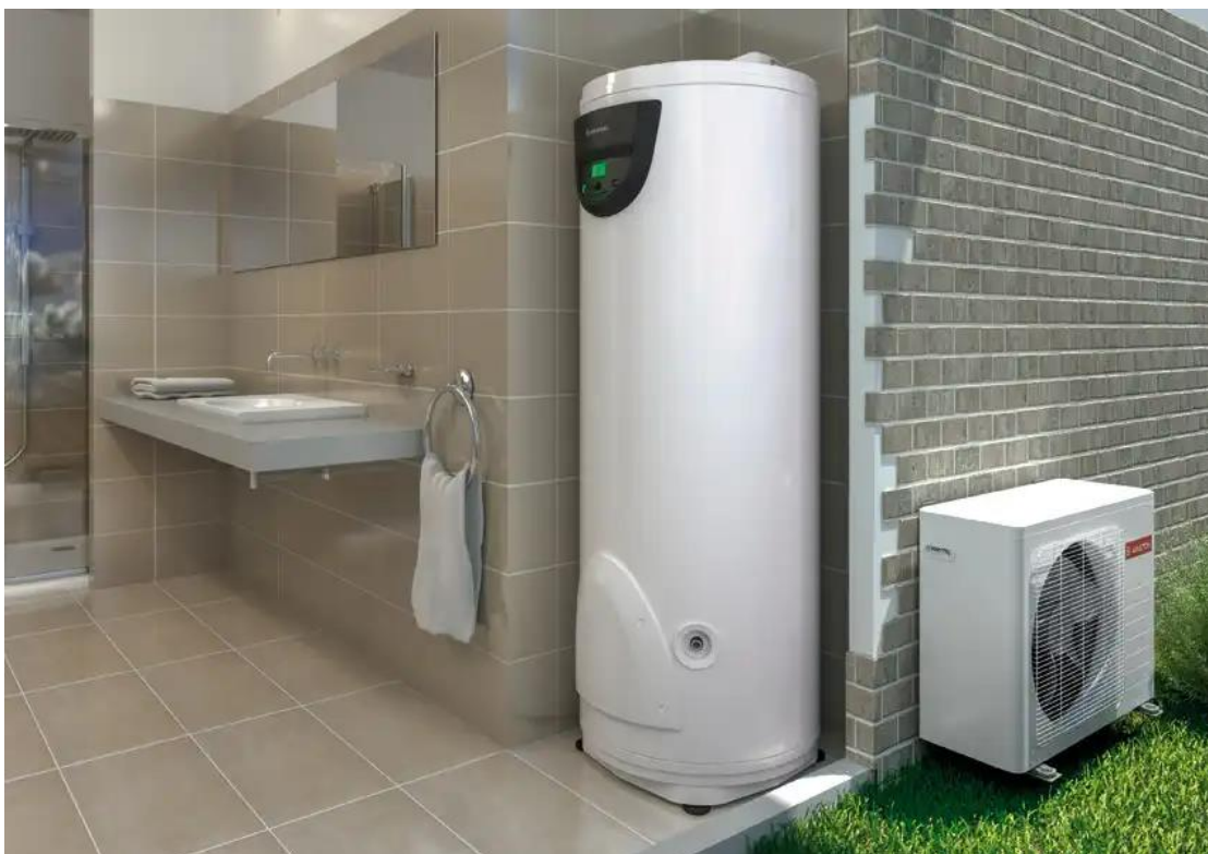
Ilustracja 77. Pomieszczenie z powietrzna pompą ciepła [źródło: https://horyzont.com/budownictwo/pompa-ciepla-ujemne-temperatury , dostęp: 05.01.2022r].
