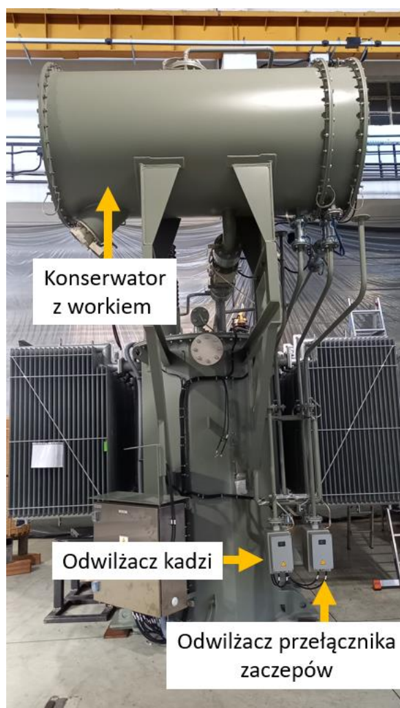
Rys. 2.12. Fotografia transformatora z zaznaczonymi kluczowymi elementami mającymi wpływ na zawilgacanie się oleju przez kontakt z powietrzem [materiały własne]
