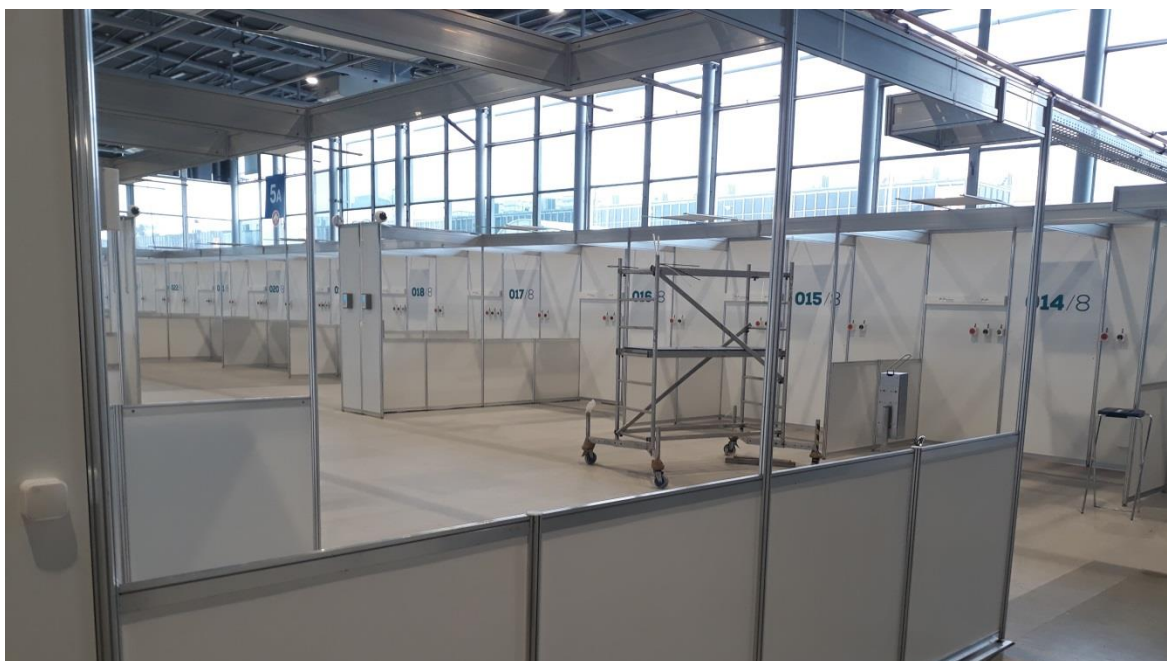
Fot. 2. Prace montażowe związane z przygotowaniem Oddziału Anestezjologii i Intensywnej Terapii szpitala tymczasowego, zlokalizowanego w hali Międzynarodowych Targów Poznańskich.
