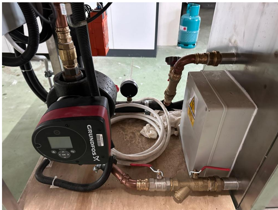
Rysunek 36 Stanowisko badawcze wytwornicy wody ziemnej - widok strony wtórnej - modułu hydraulicznego
